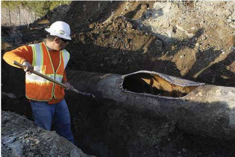
شکل ۱- خوردگی و تخریب خط لوله انتقال
